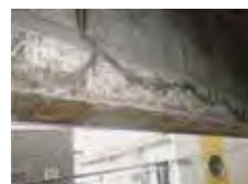
主桁の剥離・鉄筋露出
