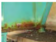
主桁端部の腐食
