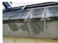
地覆の漏水・遊離石炭
