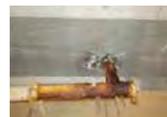
排水管の腐食
