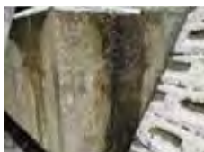
縦壁側面の凍害
