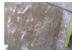
床版のひびわれ漏水・遊離石炭
